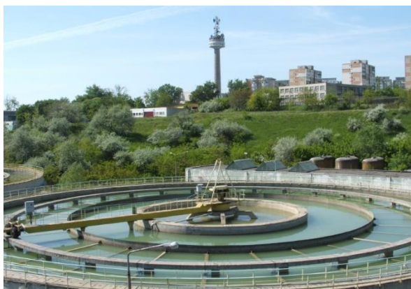
Uzina de apă nr 2-Decantor (foto3)
