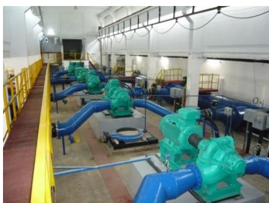
Uzina de apă nr.2- Sala pompelor (foto 2)
